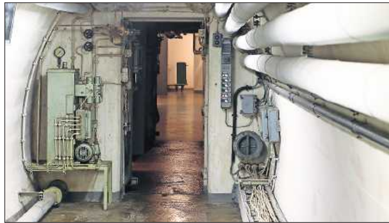
Blick ins Innere: Rohre und Kabel verlaufen durch den gesamten Bunker. Im Ernstfall hätte die Mannschaft hier 14 Tage leben können. FOTOS: GANA (4), DPA
