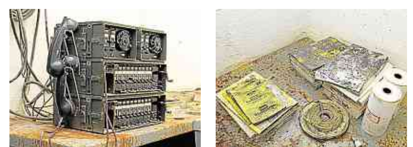
Der Fernmelderaum gehörte einst dem Bundesinnenministerium. Die Feuchtigkeit hat den Geräten in den vergangenen Jahren etwas zugesetzt.
